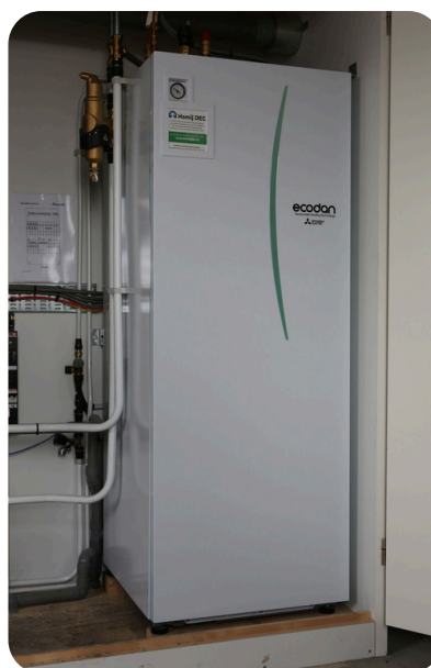
De boiler staat op zolder.
