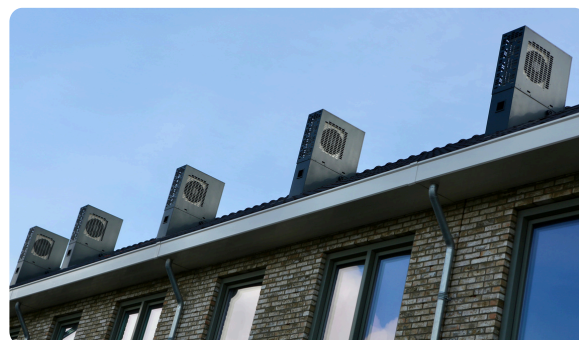
Op het dak staat de buitenunit van warmtepomp.
