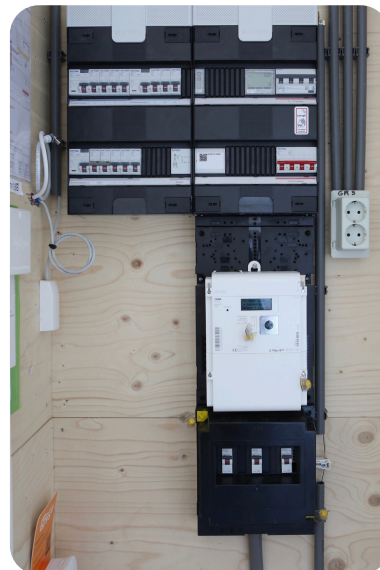
Slimme meter in de meterkast.
