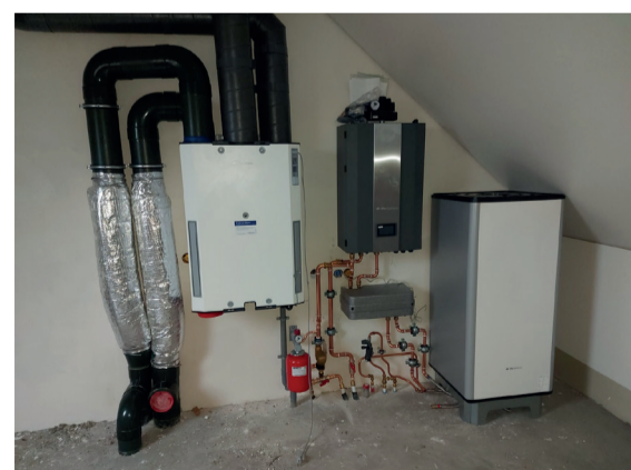
Het grijze apparaat in het midden is de lucht water warmtepomp. Het linker apparaat is een Warmte terugwinunit (wtw). Het rechter apparaat is een boiler van 200 liter.
